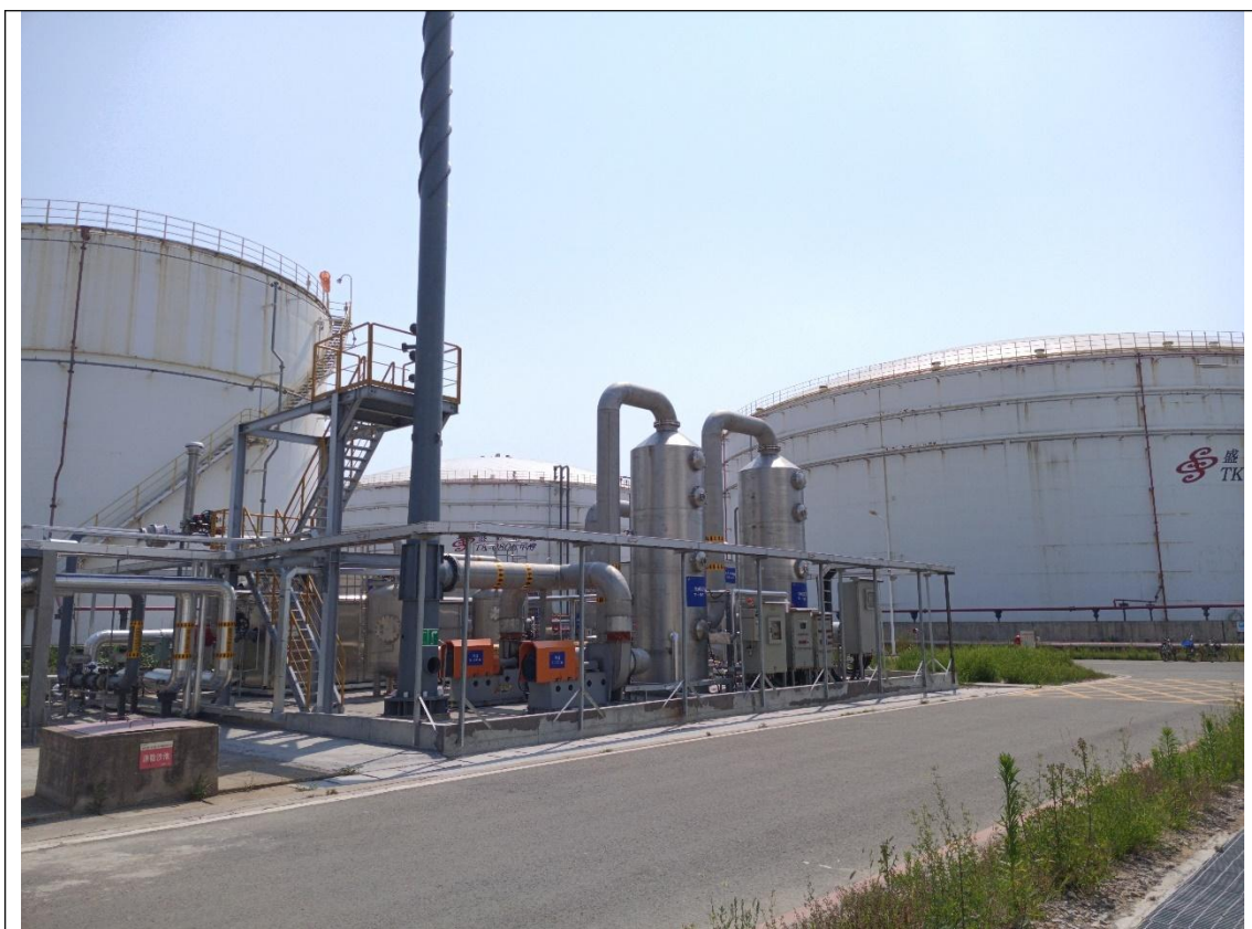
废气处理设施
