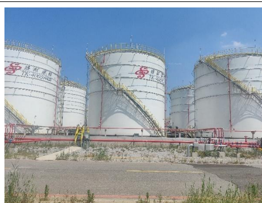
罐组九（丙烯腈储罐）
